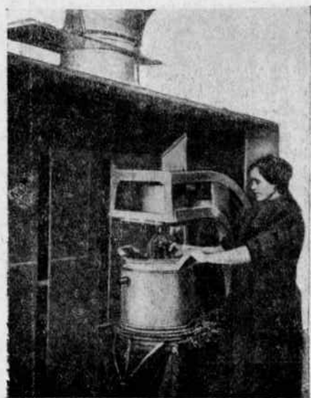
Фиг. 22. Шкаф с отсосом воздуха, загрязненного парами фенола.
